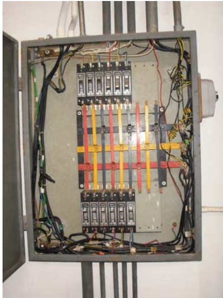
ตู้ร่นเก่า ควบคุมไฟฟ้าเพียง 1 เฟส (ไม่มีระบบ 3 เฟส)
