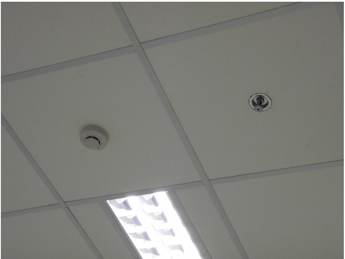
อุปกรณ์ป้องกันอัคคีภัย
