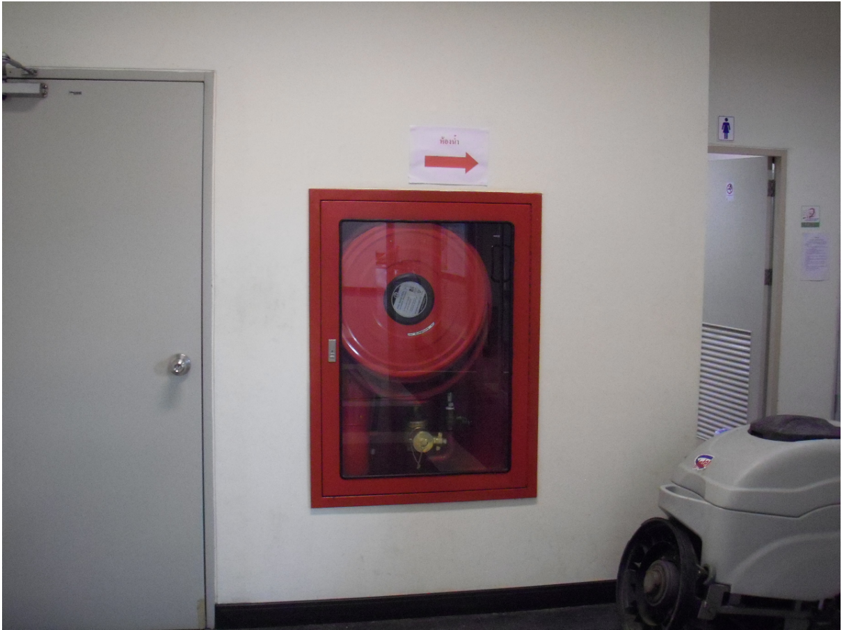
อุปกรณ์ดับเพลิงที่ติดตั้งในอาคาร
